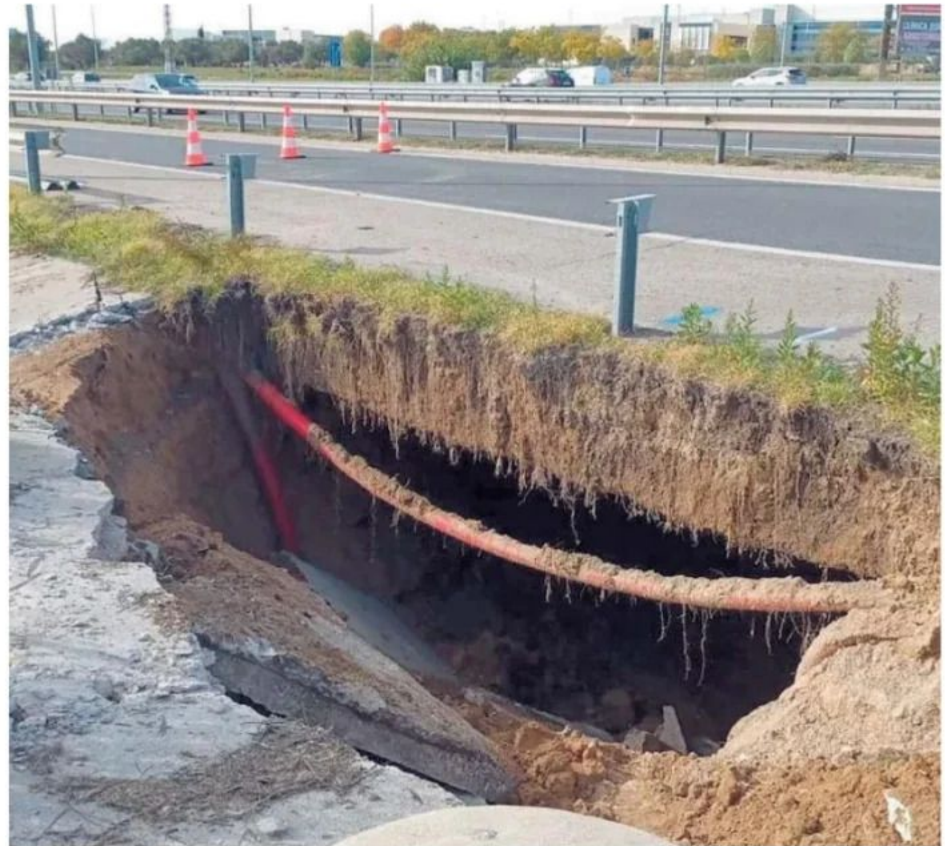
Aspecto que presenta el socavón de la A-5 a la altura de Móstoles
